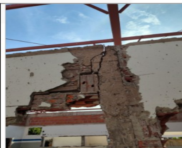
Imagem da rachadura e descolamento total, apenas ferragem segurando Localizada na divisão entre Depósito e Sala 12.
