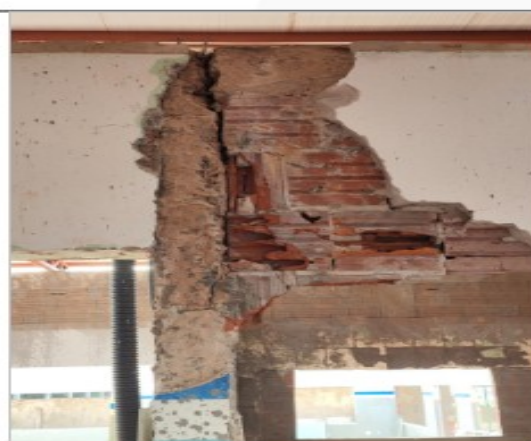
Imagem da rachadura e descolamento total, apenas ferragem segurando Localizada na divisão entre Sala Multifuncional e Sala 13.
