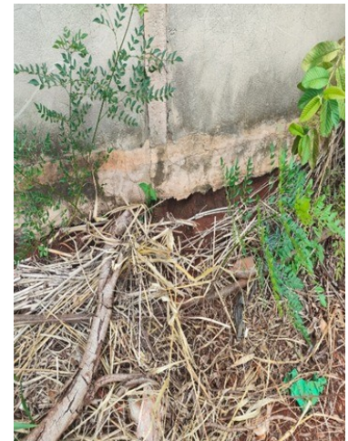
Figura 3: MURO SEM FUNDAÇÃO
