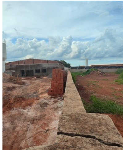
Figura 2: ESTRUTURA DO MURO DANIFICADA
