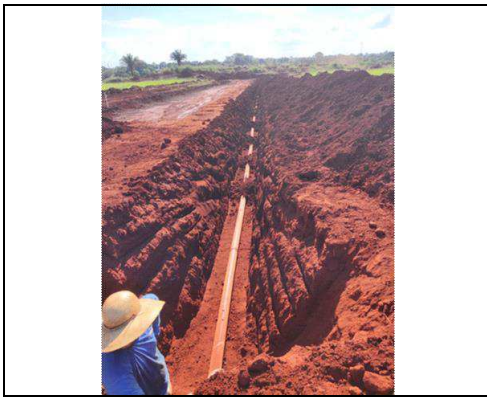
Foto 22- Rede de Esgoto
