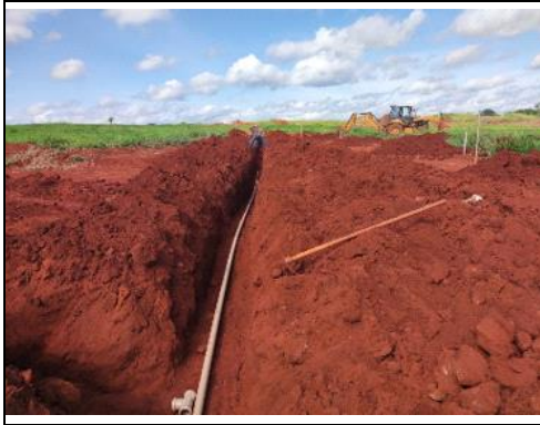
Foto 7 - Rede de Água
