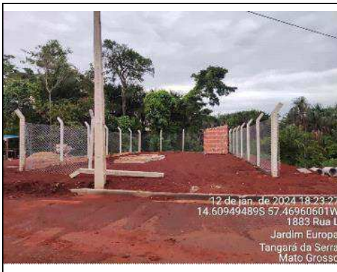
Foto 25- Estação Elevatória de Esgoto
