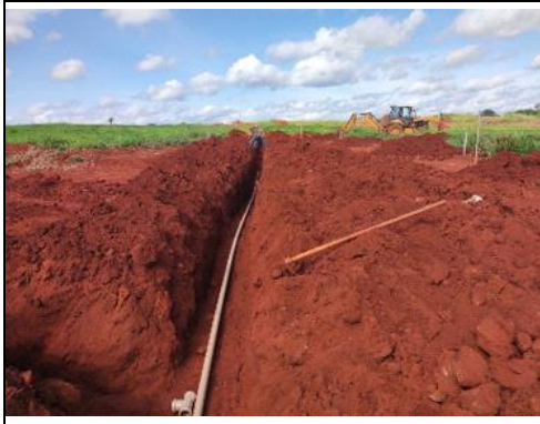
Foto 7 - Rede de Água
