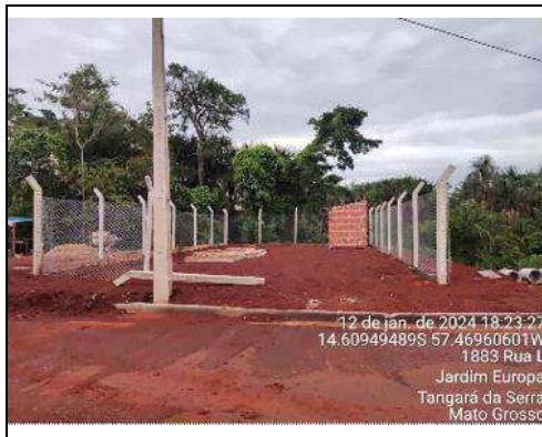
Foto 25- Estação Elevatória de Esgoto
