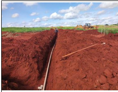
Foto 7 - Rede de Água
