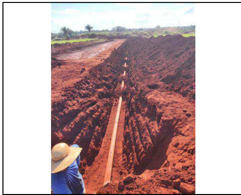
Foto 22- Rede de Esgoto
