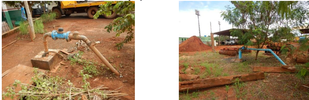
Figura 165. Captações subterrâneas do sistema SINFRA.
