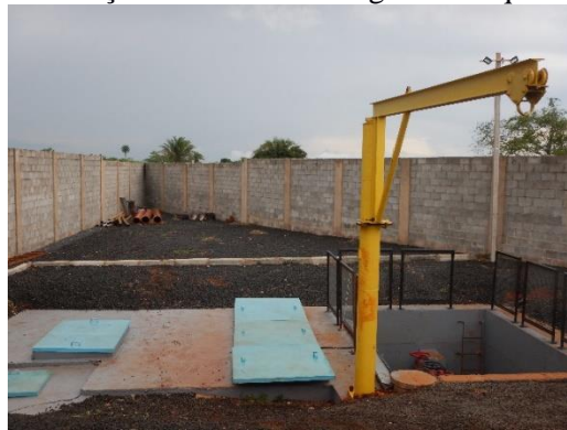
Figura 227. Estação Elevatória de Esgoto - Parque do Bosque.
