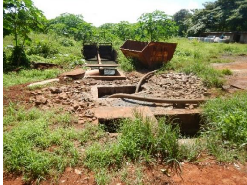
Figura 234. Caixa de passagem da entrada da ETE.
