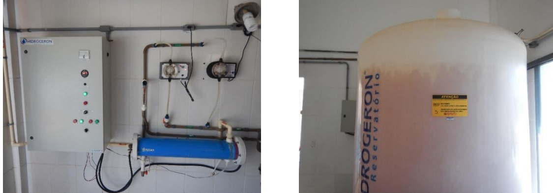
Figura 191. Sistema de geração de hipoclorito de sódio.
