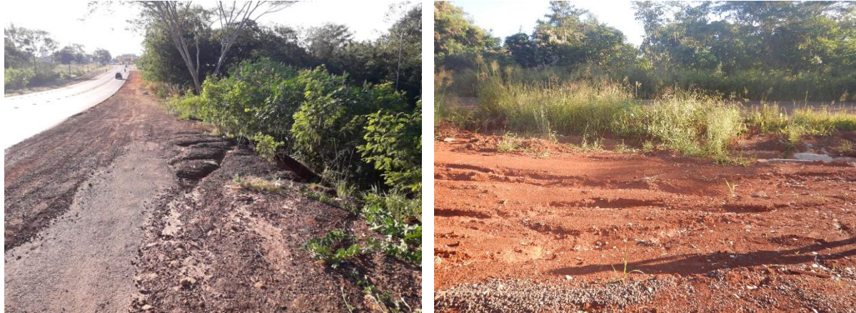
Figura 406. Processos erosivos registrados próximos ao fundo de vale.
