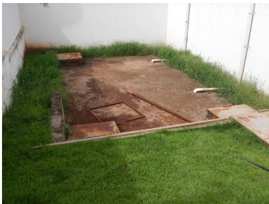
Figura 226. Reservatório de acúmulo da EEE - Paris.
