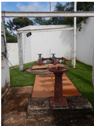
Figura 225. Elevatória do residencial Paris.
