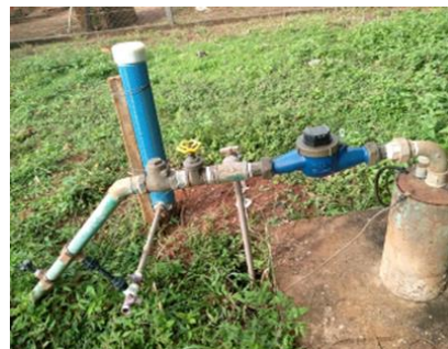
Figura 446. Poço 2 em S. Joaquim do Boche.
