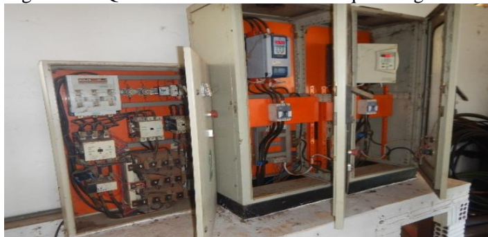
Figura 179. Quadros de comando do recalque de água bruta.
