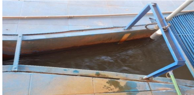
Figura 182. Calha Parshall 12” e medidor de vazão.
