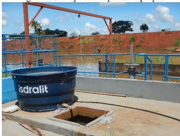
Figura 155. Poço de sucção da captação.
