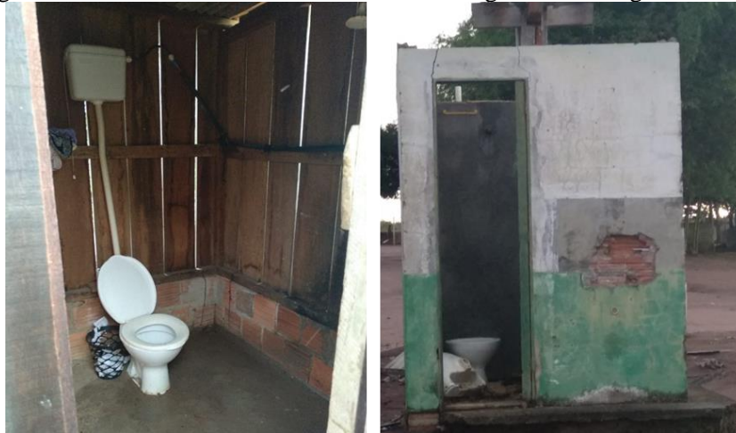
Figura 474. Banheiros utilizados nas aldeias indígenas em Tangará da Serra.
