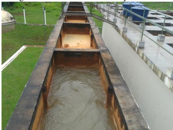
Figura 185. Câmaras de floculação da ETA.
