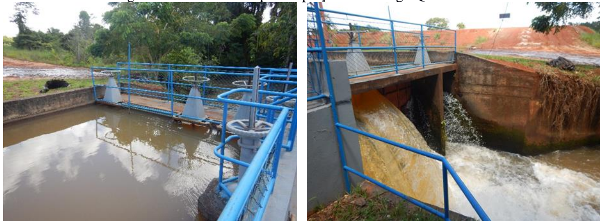
Figura 154. Barramento para captação no Córrego Queima-Pé.
