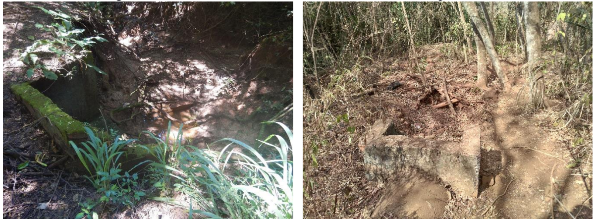
Figura 407. Processos erosivos devido à ausência de dissipadores.
