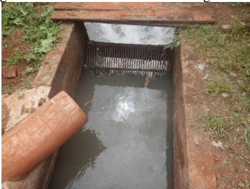
Figura 235. Gradeamento de sólidos grosseiros.
