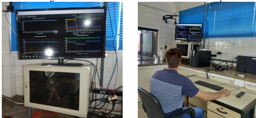
Figura 198. Tela de controle do sistema de reservação.
