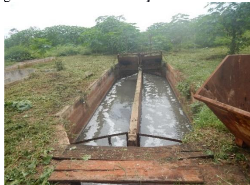
Figura 236. Caixa de remoção de areia da ETE.
