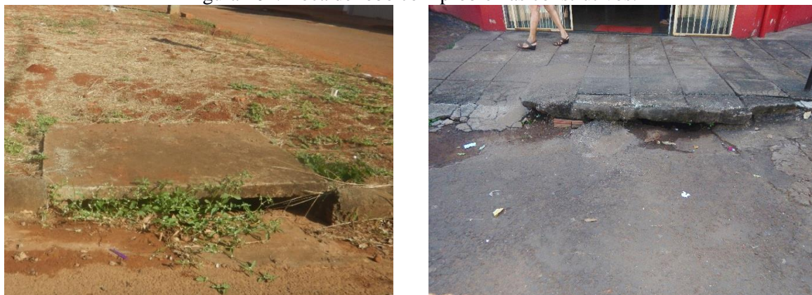
Figura 401. Boca de lobo com problemas construtivos.
