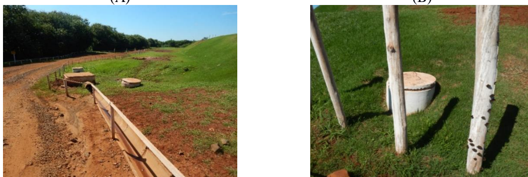
Figura 317. (A) Canaletas de drenagem superficial (B) Caixa de passagem
