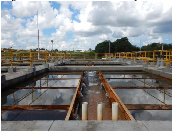
Figura 186. Decantadores da ETA Queima-Pé.
