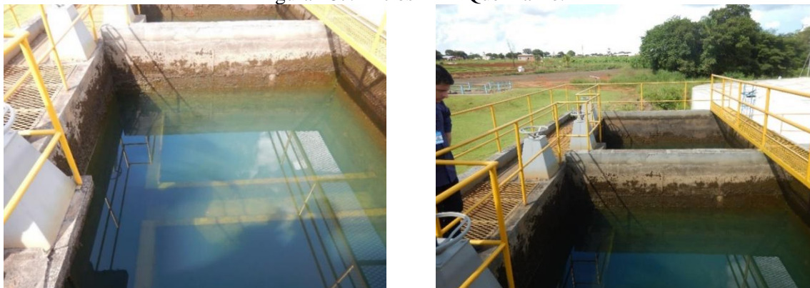
Figura 187. Filtros ETA Queima-Pé.
