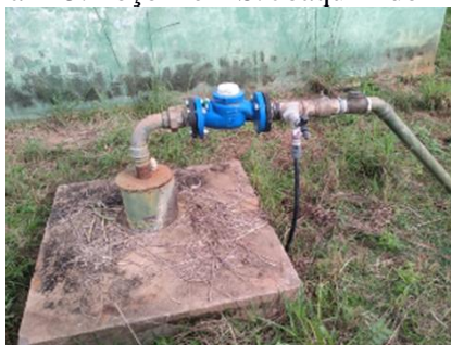
Figura 445. Poço 1 em S. Joaquim do Boche.
