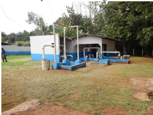
Figura 221. Estação Elevatória de Esgoto - Jardim do Sul.
