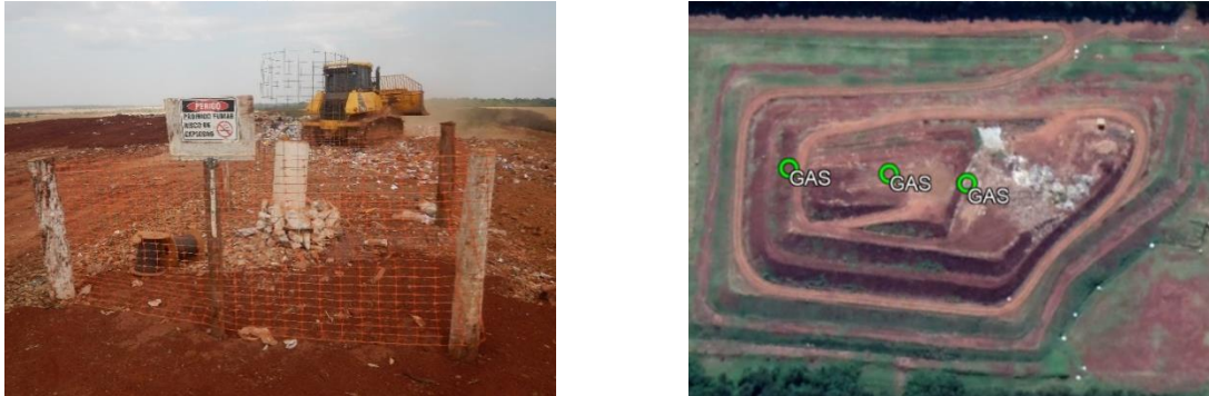
Figura 315. (A) Drenos de gases (B) Localização das chaminés do aterro sanitário
