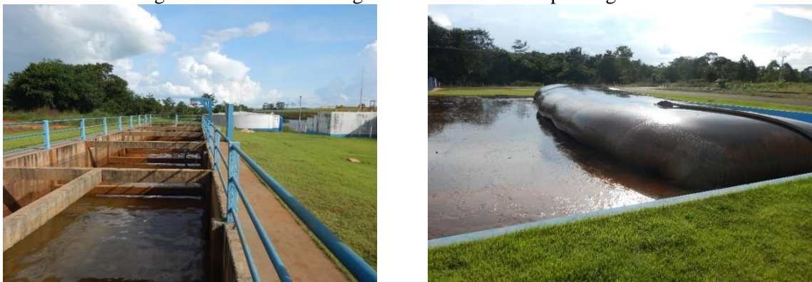
Figura 192. Leito de Secagem do lodo e tecido especial geotêxtil.
