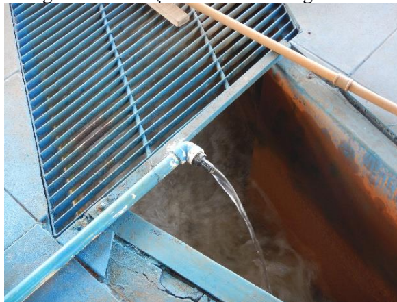
Figura 183. Adição de sulfato na água bruta.
