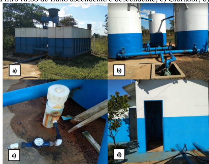
Figura 463. Estação de Tratamento de Água compacta na Agrovila 2. a) Floculador e decantador; b) Filtro russo de fluxo ascendente e descendente; c) Clorador; d) Casa de bomba.
