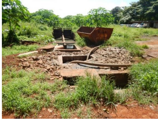
Figura 234. Caixa de passagem da entrada da ETE.
