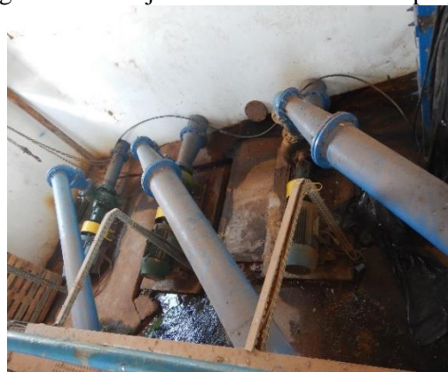
Figura 178. Conjuntos motobombas da captação.
