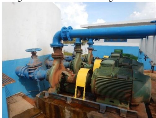
Figura 194. Elevatória de água tratada.
