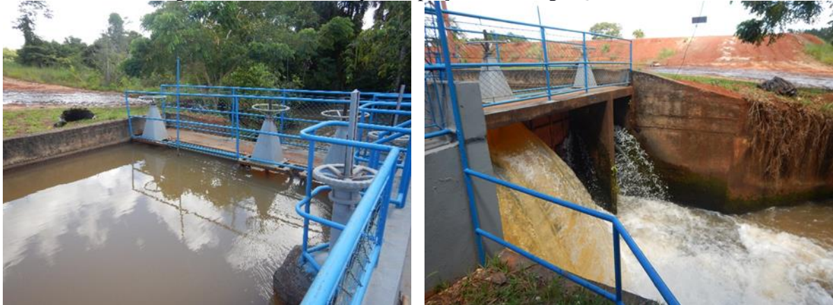
Figura 154. Barramento para captação no Córrego Queima-Pé.
