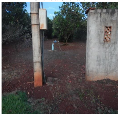
Figura 174. Poço e quadro de comando da Chácara Uberaba.
