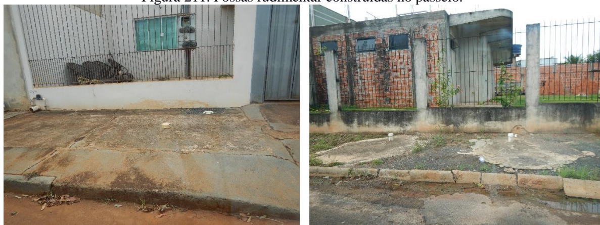
Figura 211. Fossas rudimentar construídas no passeio.
