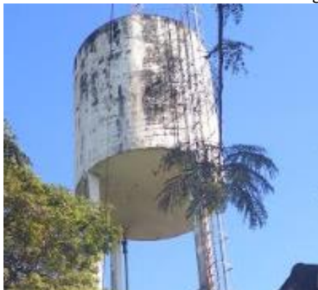
Figura 437. Reservatório do distrito de Progresso
