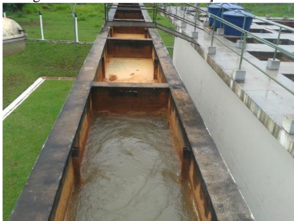
Figura 185. Câmaras de floculação da ETA.
