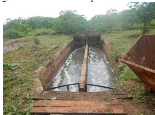
Figura 236. Caixa de remoção de areia da ETE.
