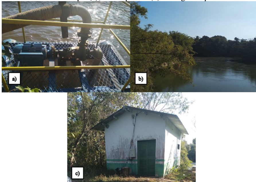
Figura 462. Sistema de recalque (a), Rio Sepotuba (b) e abrigo do quadro de comando (c).
