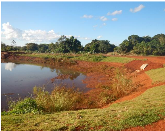
Figura 373. Bacia de retenção com dissipador de energia. Bairro Jardim Califórnia.
