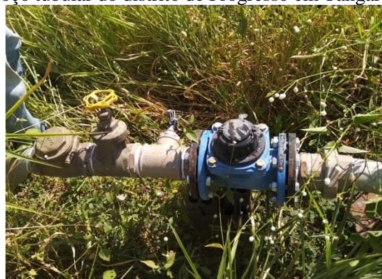
Figura 433. Poço tubular do distrito de Progresso em Tangará da Serra MT.
