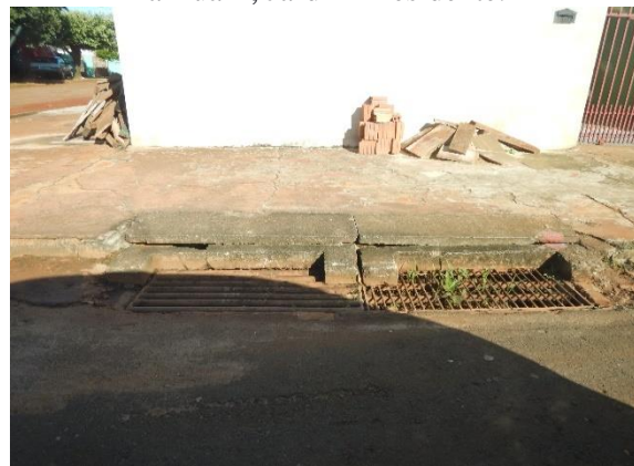
Figura 385. Boca de lobo com grelha na Rua E, Jardim Presidente.
