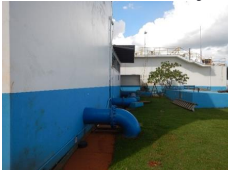
Figura 180. Entrada da Adutora de água bruta.
