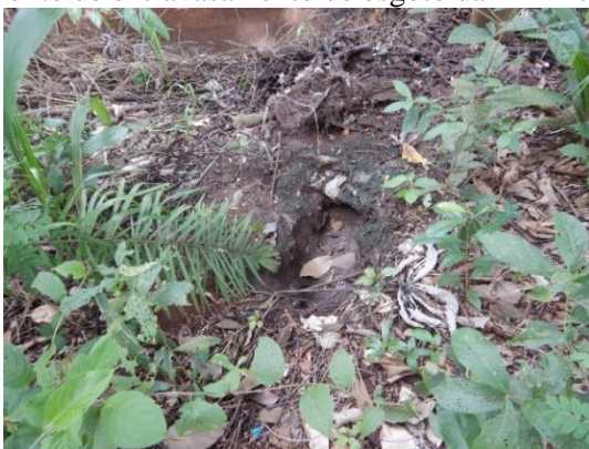
Figura 223. Ponto de extravasamento de esgoto da EEE - Jardim do Sul.
