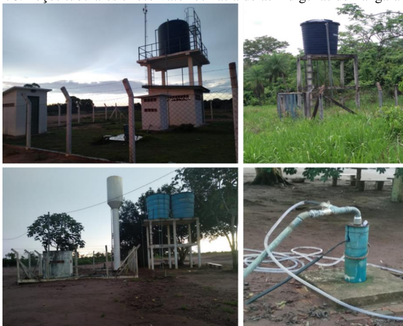
Figura 470. Poços tubulares e reservatórios nas aldeias indígenas de Tangará da Serra.
