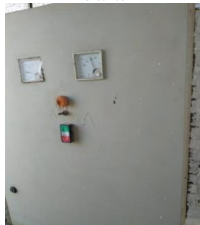
Figura 436. Quadro de comando do poço do distrito
