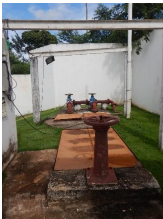
Figura 225. Elevatória do residencial Paris.
