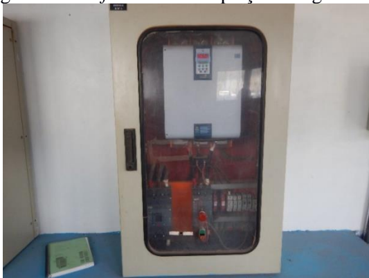
Figura 197. Soft starter da captação de água bruta.
