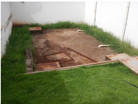
Figura 226. Reservatório de acúmulo da EEE - Paris.
