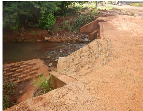
Figura 374. Ponto de lançamento com dissipador de energia na MT-480, no bairro Dona Julia.
