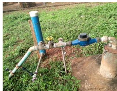
Figura 446. Poço 2 em S. Joaquim do Boche.
