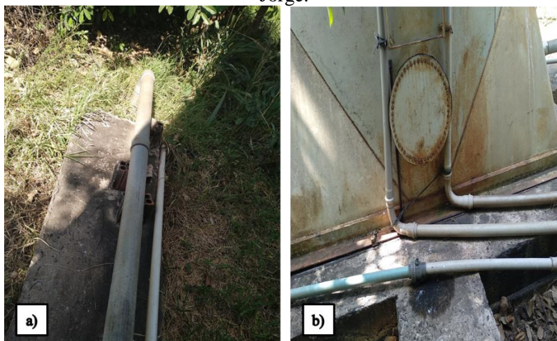
Figura 454. (a) Poço tubular, (b) base do reservatório de abastecimento do distrito de São Jorge.
