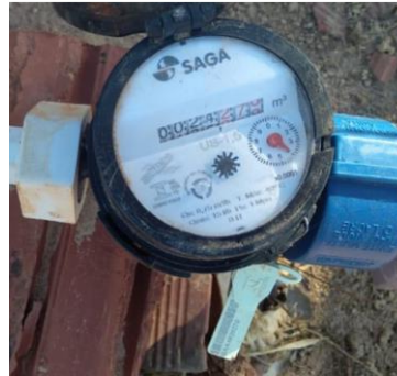
Figura 439. Hidrômetro em uma ligação predial no distrito de Progresso.
