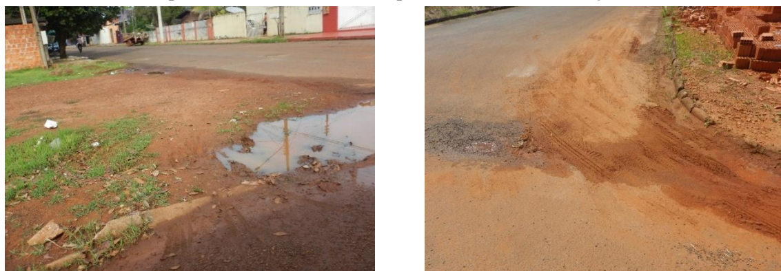
Figura 398. a) Ausência de meio-fio e acúmulo de águas pluviais; b) Sedimentos na sarjeta causados pelo carreamento do solo exposto nas vias de circulação.
