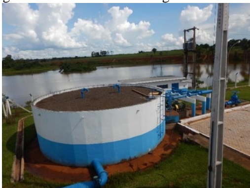
Figura 193. Reservatório de água tratada-RAP.
